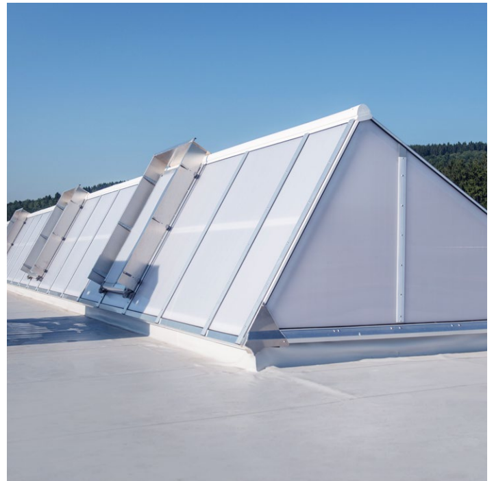
LAMILUX Lichtband S auf der Industriehalle der Kemper GmbH in Olpe
